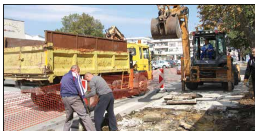
Започна подмяната на тротоарните плочи по улица „Георги Кирков“ от кръстовището с „Дончо Стойков“ до светофарната уредба.
